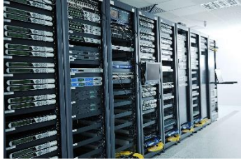
Data center A
